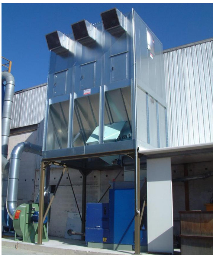
Exemple d'un filtre FDCC de 3 modules
